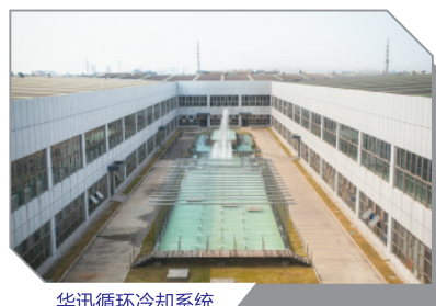
华迅循环冷却系统
